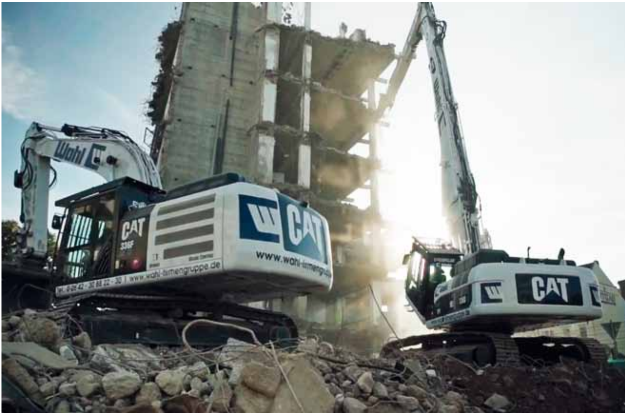
Abbruch Berliner Freiheit in Bonn. Dort hatte ein Cat Kettenbagger 336D UHD Langfront mit einer Reichweite von 21 Metern seinen Einsatz. Fotos: Wahl
