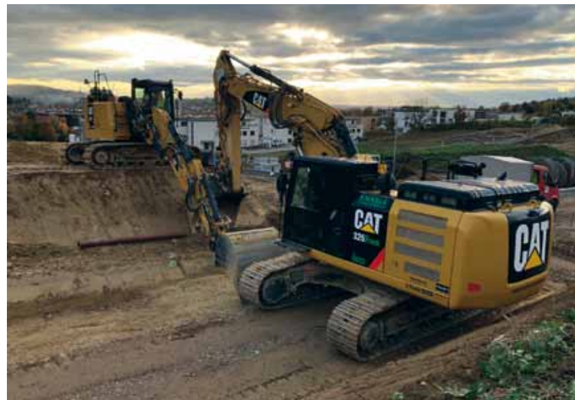
Die Erschließung der zehn Hektar großen Fläche mit 120 Bauplätzen zählt zum bislang größten Infrastrukturprojekt.
